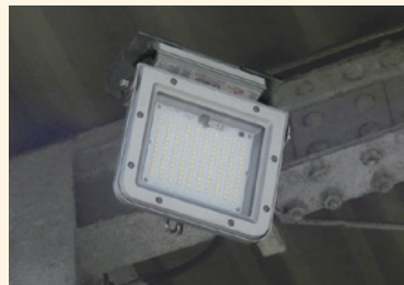
LED照明(工場屋外灯)
